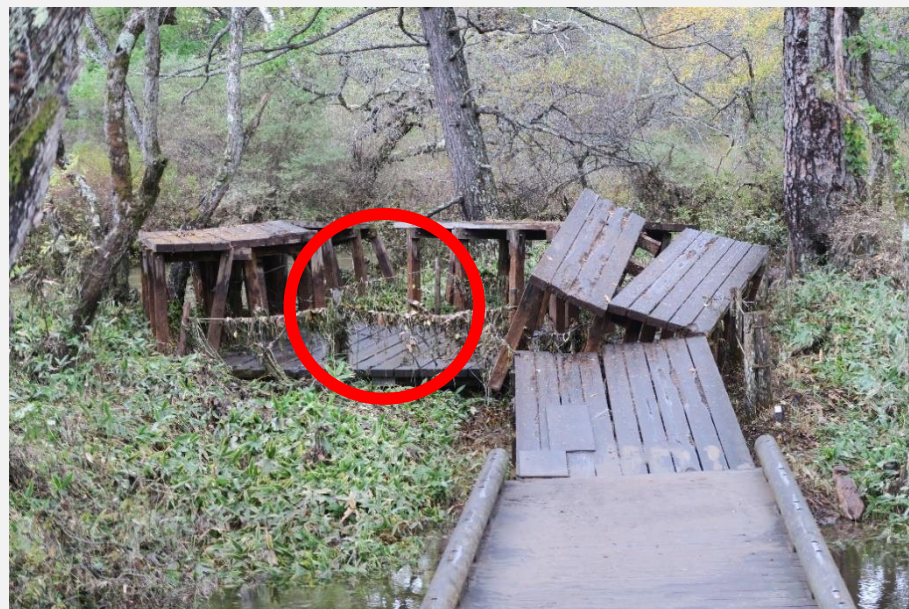
①湯川の増水により浮き上がり流された戦場ヶ原の木道
